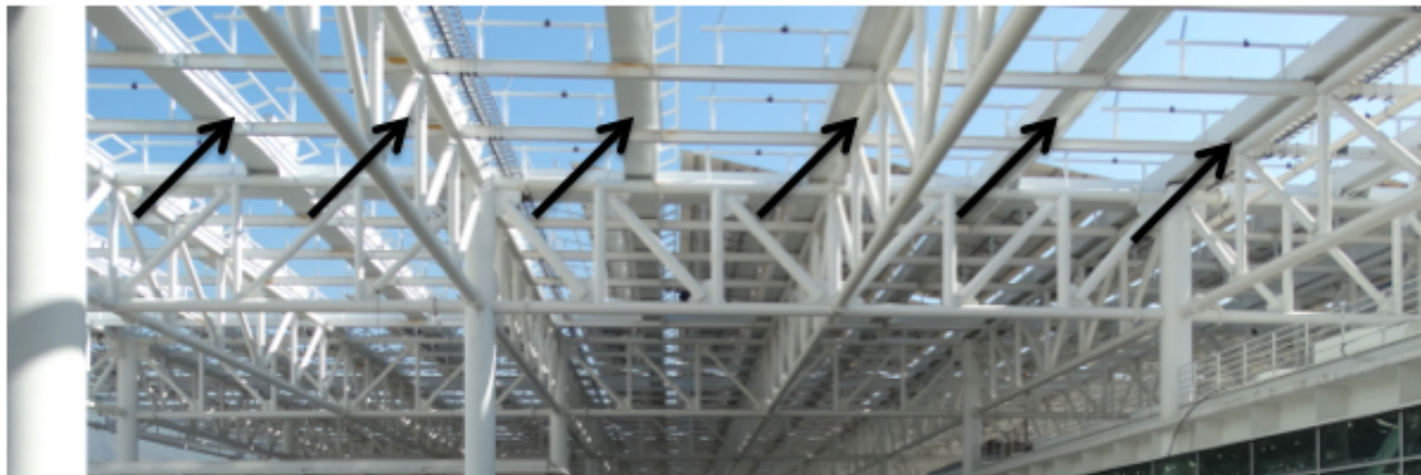
Fotografía # 27 cubierta con los canalones para el agua pluvial Fuente. D. Adame Arcos 2015
