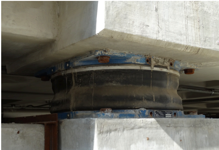
Fotografía # 26. Aisladores sísmicos Fuente. D. Adame Arcos 2015
