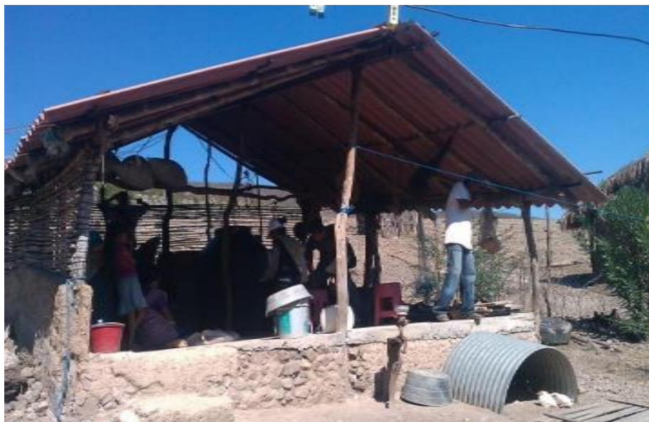
Construcción de viviendas en la comunidad Fotografía tomada: Azucena Rodríguez, 15 de octubre del 2016
