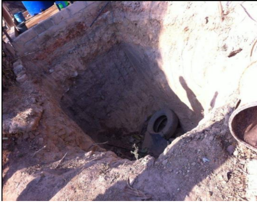
Fig. 12. Pozo que se utilizará para fosa séptica
