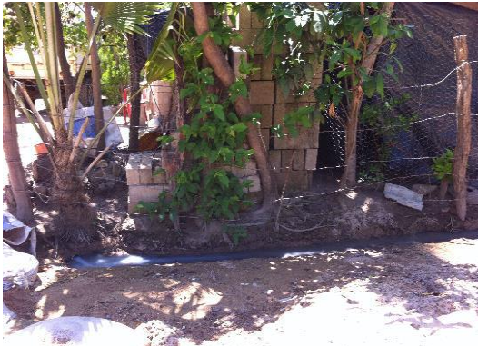
Fig. 14. Agua residual en la calle principal
