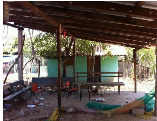
Fig. 15. Escuela sin servicio y en mal estado
