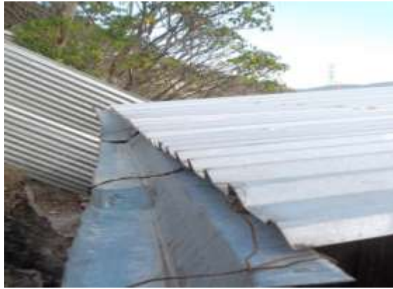
Imagen 10.- Canaleta de lamina galvanizada, para conducir el agua de lluvia.
