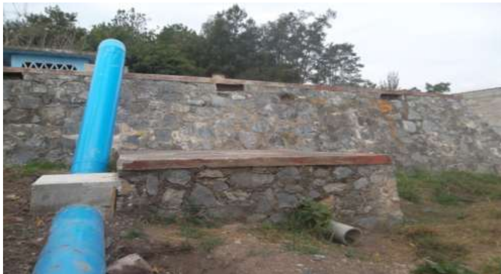
Imagen 6.- Tanque de Almacenamiento Peña Rajada
