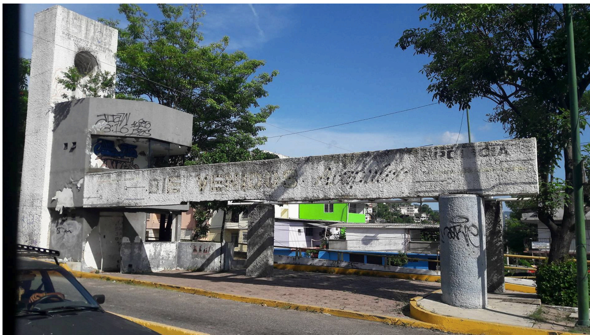
[Foto 5.2] Fuente: Archivo Propio (2017). Modulo de policías de la secretaria de seguridad pública, ubicado a la altura de la I griega sobre la Av. Ruiz Cortines, en la Col. Garita, presenta daños por ataques de “balaceras” de igual manera se observa como el vandalismo se a apoderado del inmueble.
